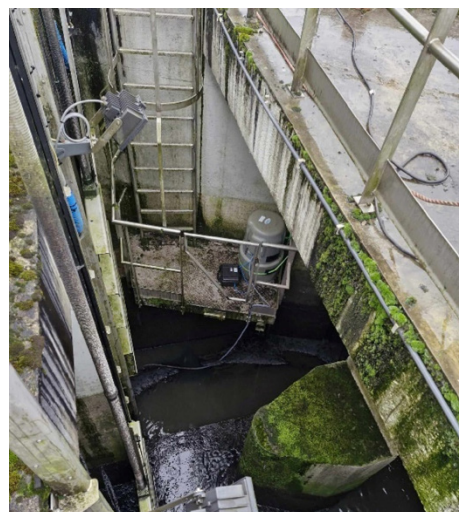
Exemple d'échantillonneur placé à l'aduction d'une station de pompage du réseau
